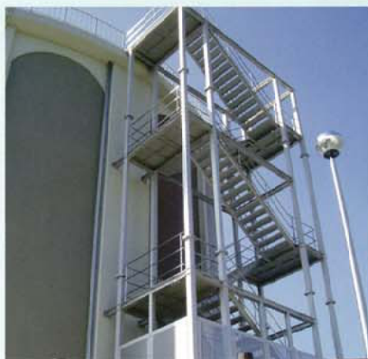
配水池 ステンレス製 昇降階段
