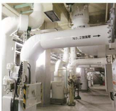
下水処理場送風機設備
