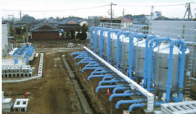
浄水場機械設備
